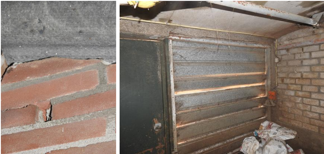
Afbeelding 2 voorbeeld kieren in de muur en onder het dak. Afbeelding 3. Kieren opslagruimte.
